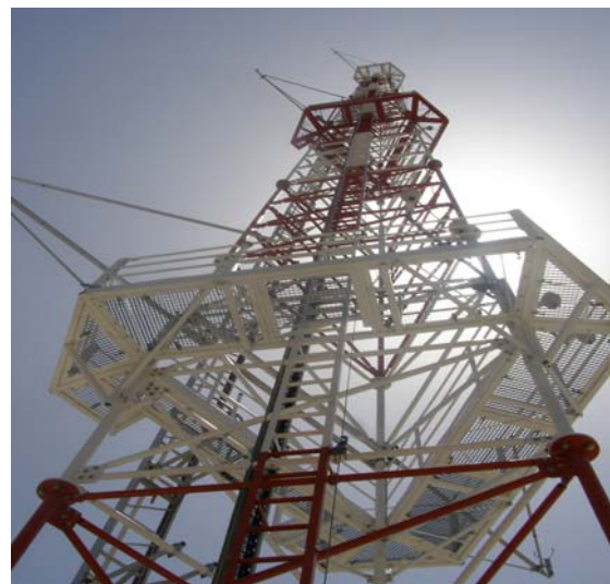
Torre meteorológica en Vandellós
