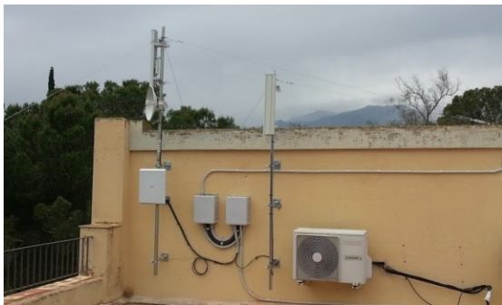
Fig. 11. Detall de les antenes Guifi.net instal·lades a l'OE.
