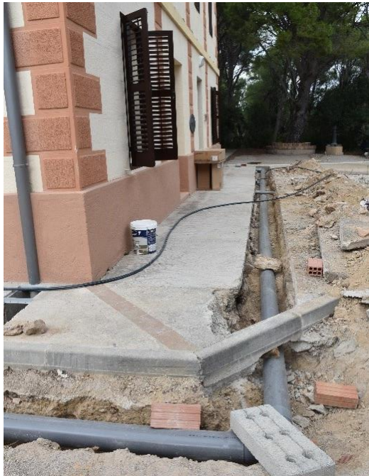
Fig. 16. Detall de les noves conduccions d'aigua i millora d'infraestructures de serveis. Detalle de las nuevas conducciones de agua y mejora de infraestructuras de servicios.
